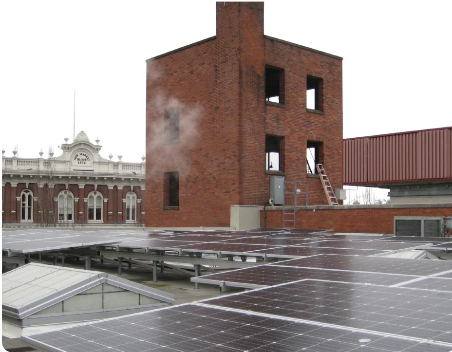
Microgrid, caserne des pompiers de Portland
